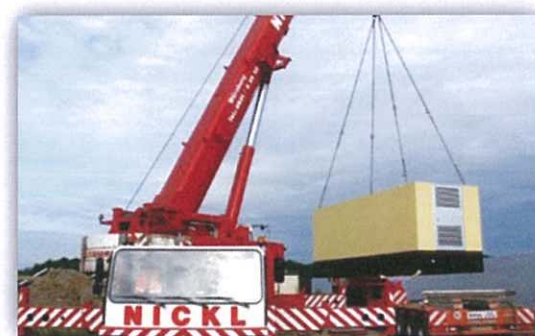
Exemple d'acheminement d'un poste technique préfabriqué
