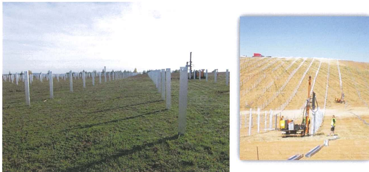
Exemple de pieux battus dans le sol avec une batteuse visible en arrière-plan
